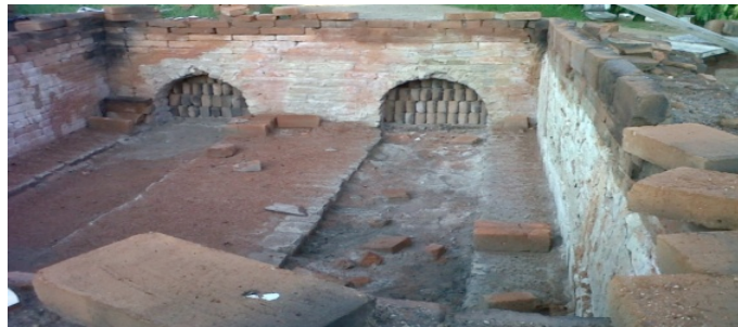
Caja inferior de un horno. En una ladrillera cercana a la ciudad de León.
