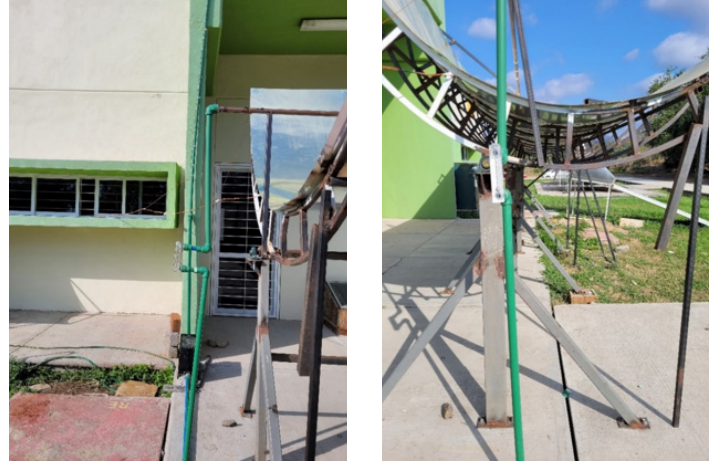
Figura 19. Instalación hidráulica. Fuente: elaboración propia
